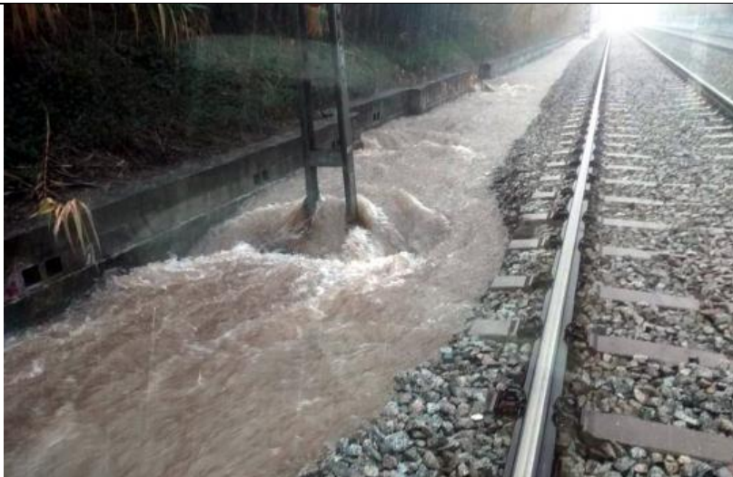
Figura 62. Afectació de la via del tren de Cerdanyola del Vallès per inundacions
